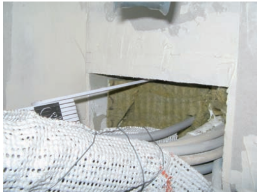
Abb. 4.47: An den seitlichen Randflächen nicht beschichtete Mineralfaserplatte (zwischen Zollstock und eingedrückter Mineralfaserplatte)
