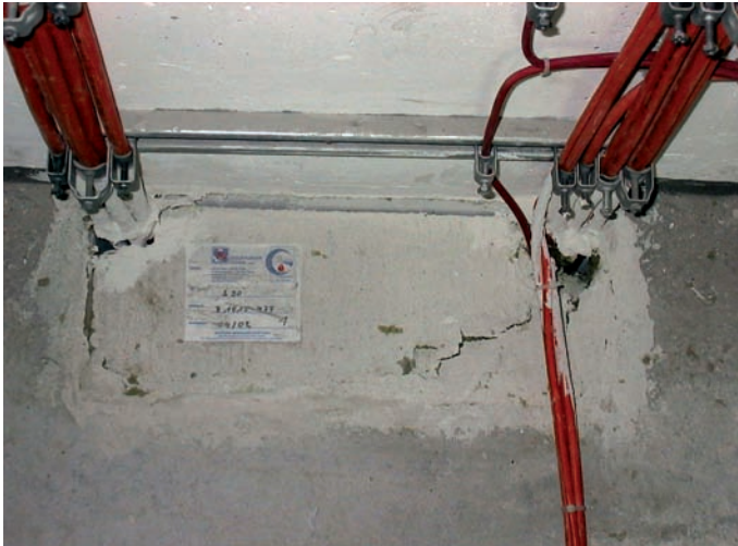
Abb. 4.52: Nicht ausreichend gesichertes Decken- schott (beidseitig schon eingetreten)
