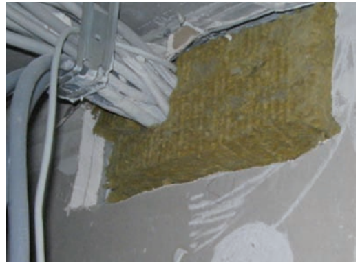
Abb. 4.51: Fehlende umlaufende GKF-Platten, die die offenen C-Profile schützen, fehlende seitliche Beschichtung usw.
