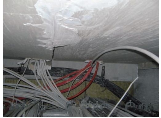
Abb. 4.49: Fehlende Beschichtung der elektrischen Leitungen und der Mineralfaserplatten auf der unteren Seite eines Kabelschotts in einem Elektrosteiggeschacht (Ansicht von unten nach oben)
