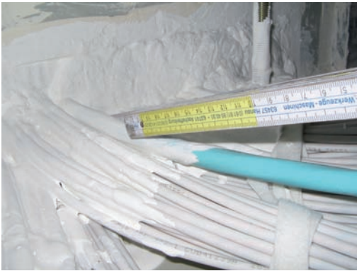
Abb. 4.44: Nachweis der fehlenden Schottungstiefe im Bereich des nicht verschlossenen Zwickels zwischen Leitungsbündeln
