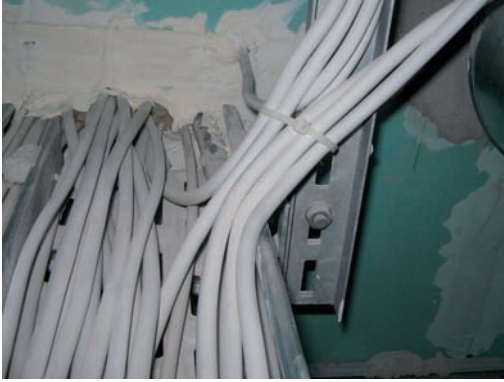
Abb. 4.48: Einseitig nicht mit der reaktiven Brandschutzbeschichtung versehene elektrische Leitungen und Leitungstragekonstruktion
