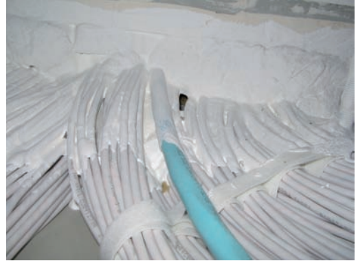
Abb. 4.43: Brandschutztechnisch nicht ausreichend verschlossene Zwikel zwischen Leitungsbündeln
