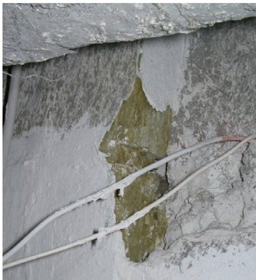
Abb. 4.46: Seitlich teilweise nicht beschichtete Mineralfaserplatte, die zudem noch zu weit über die Rohbauöffnung hinausragt
